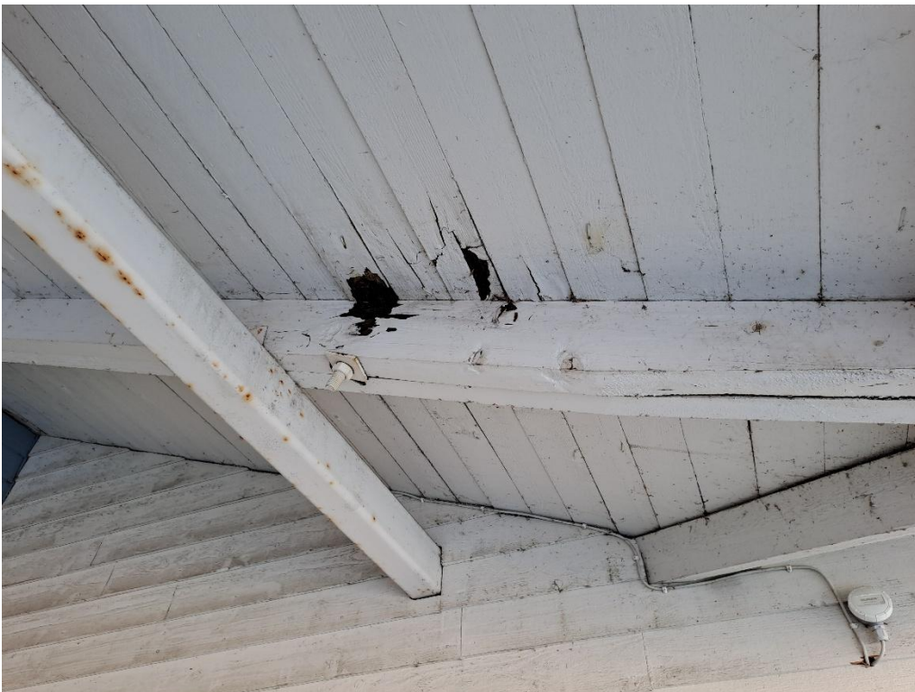
Kuva 4. Lahovaurioituneita katoksen puuosia.
