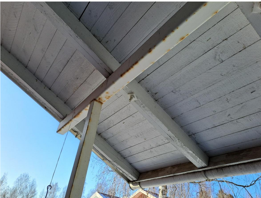
Kuva 2. Ruostevaurioituneita katoksen metallirakenteita
