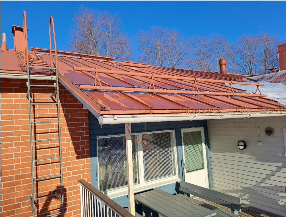
Kuva 1. Vesikattopintaa, sekä uusittava lumieste
